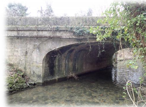
Ouvrage hydraulique de la RD31 Petit Fusain à Courtempierre favorable avec présence avérée
